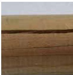
Cracks/Grietas/Fente/Risse/ Crepe/ Barsten/Fendas
