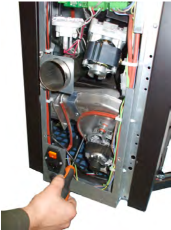
Fig. 84 - Reinigung Rauchgasansauggerät: Phase 1
