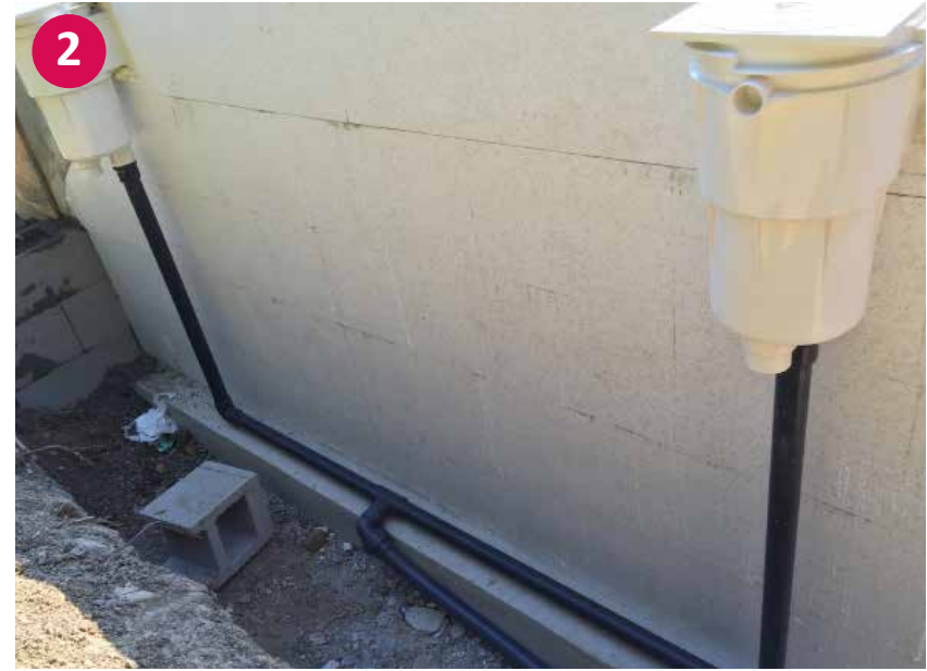
▲ Verrohrung von 2 Skimmer
