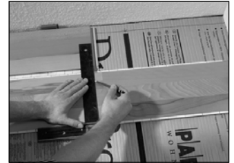
Die letzte Dielle der ersten Reihe wird unter Beachtung des Wandabstands auf die notwendige Länge gekürzt. Das abgeschnittene Stück der Dielle wird als Beginn der zweiten Reihe verwendet.
