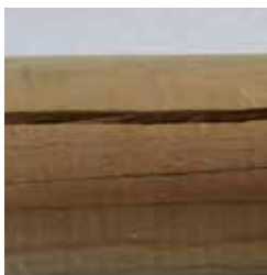
Cracks/Grietas/Fente/Risse/ Crepe/ Barsten/Fendas
